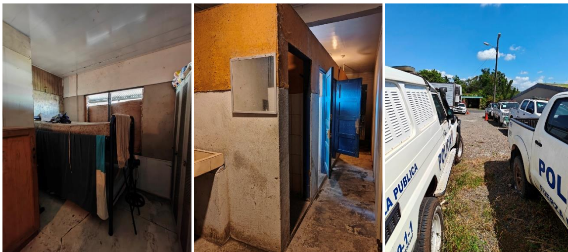
Fotos: izquierda, dormitorio personal masculino; centro, área de baños del personal; derecha, patio con vehículos en mal estado.
